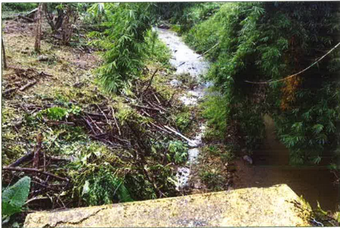
Figura 3. Detalles del Puente No 2. Se observa la sección del puente, cuya capacidad hidráulica es insuficiente, y el río Naranjo. Barrio Nuevo, Bayamón.
