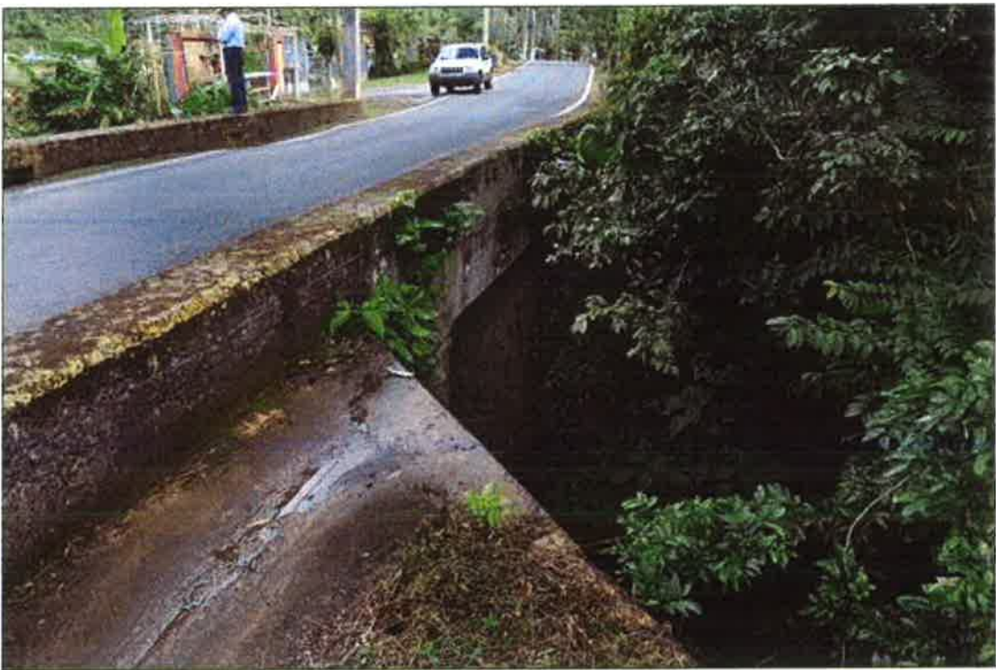
Figura 3. Detalles del Puente No 3. Se observa la sección del puente en ambas caras, cuya capacidad hidráulica es insuficiente. Barrio Nuevo, Bayamón.
