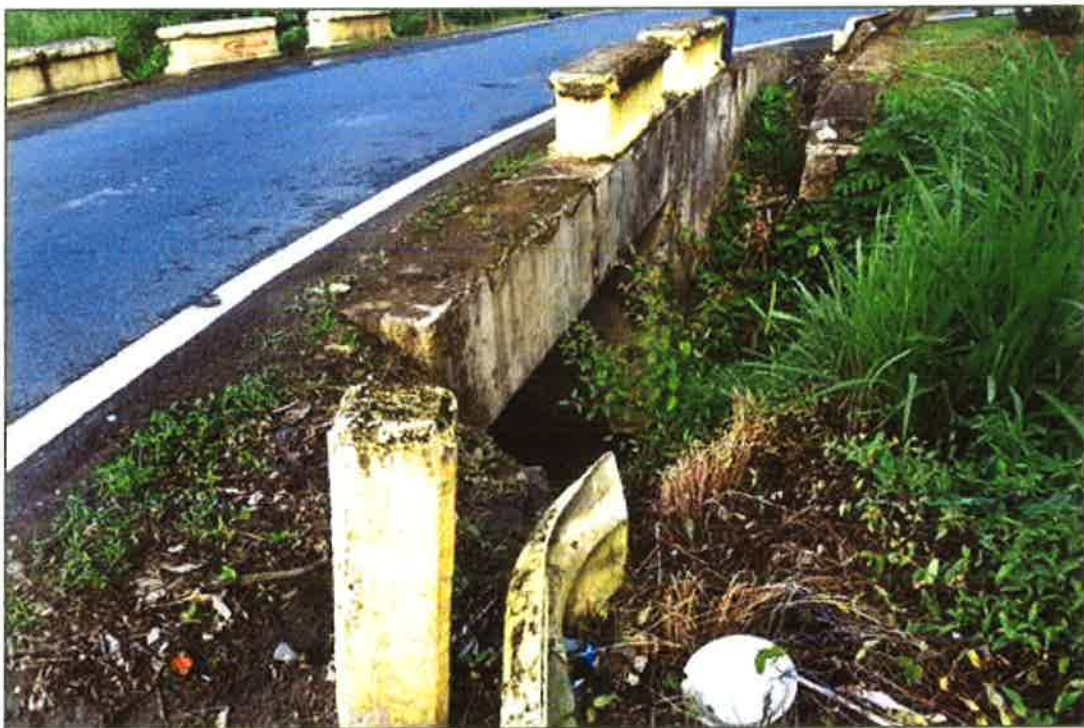
Figura 3. Detalles del Puente No 1. Se observa la sección del puente, cuya capacidad hidráulica es insuficiente. Barrio Nuevo, Bayamón.
